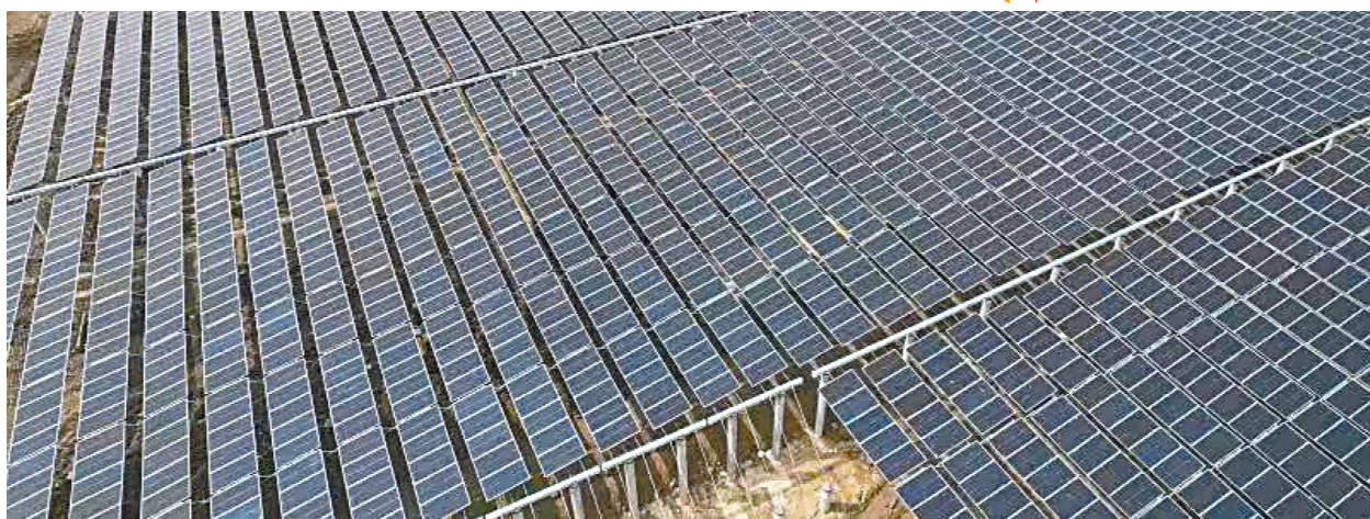
通威台山“渔光一体”二期项目
