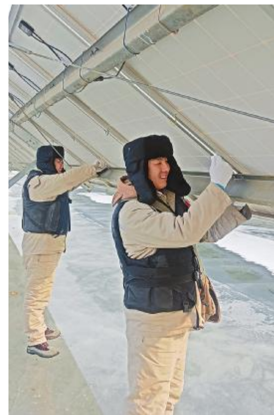
东港基地运维人员紧固螺栓
